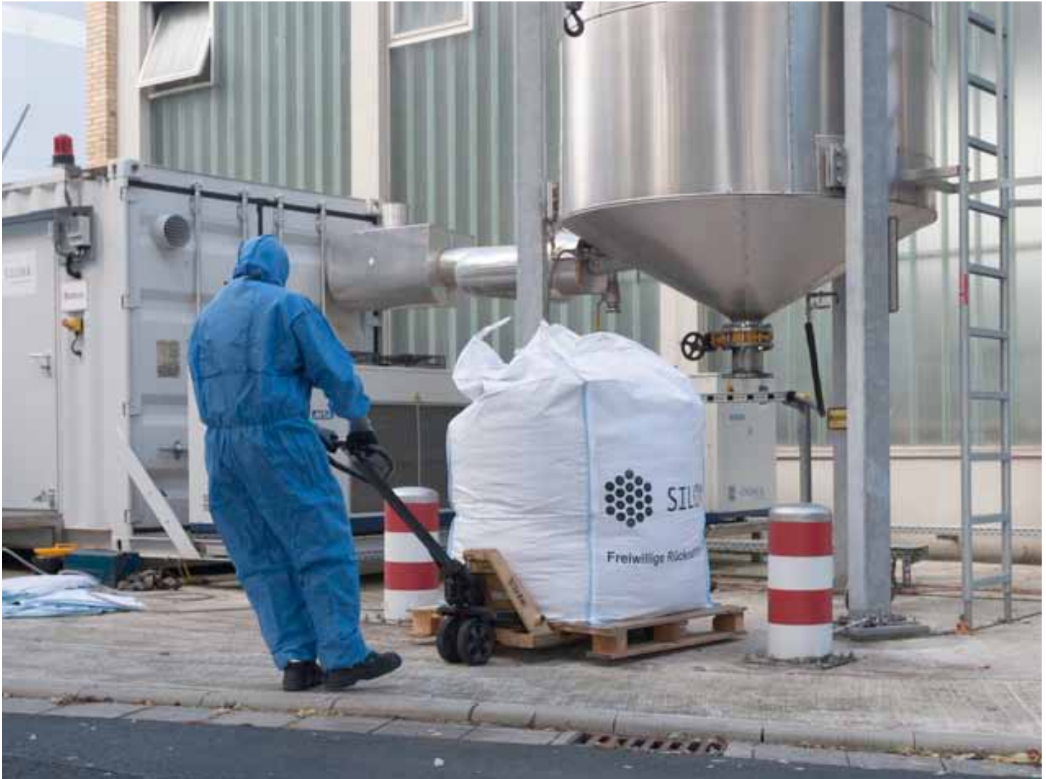
Ein Facharbeiter der Siloxa AG entsorgt unter Einhaltung von Sicherheitsstandards die verbrauchte Aktivkohle.
